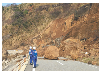
能登半島地震で寸断された道路
